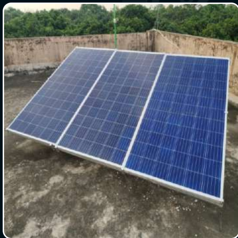
Rooftop PV module
