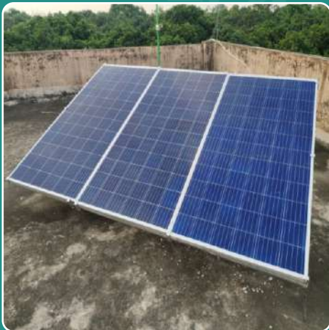
Rooftop PV module
