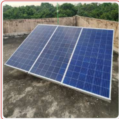
Rooftop PV module
